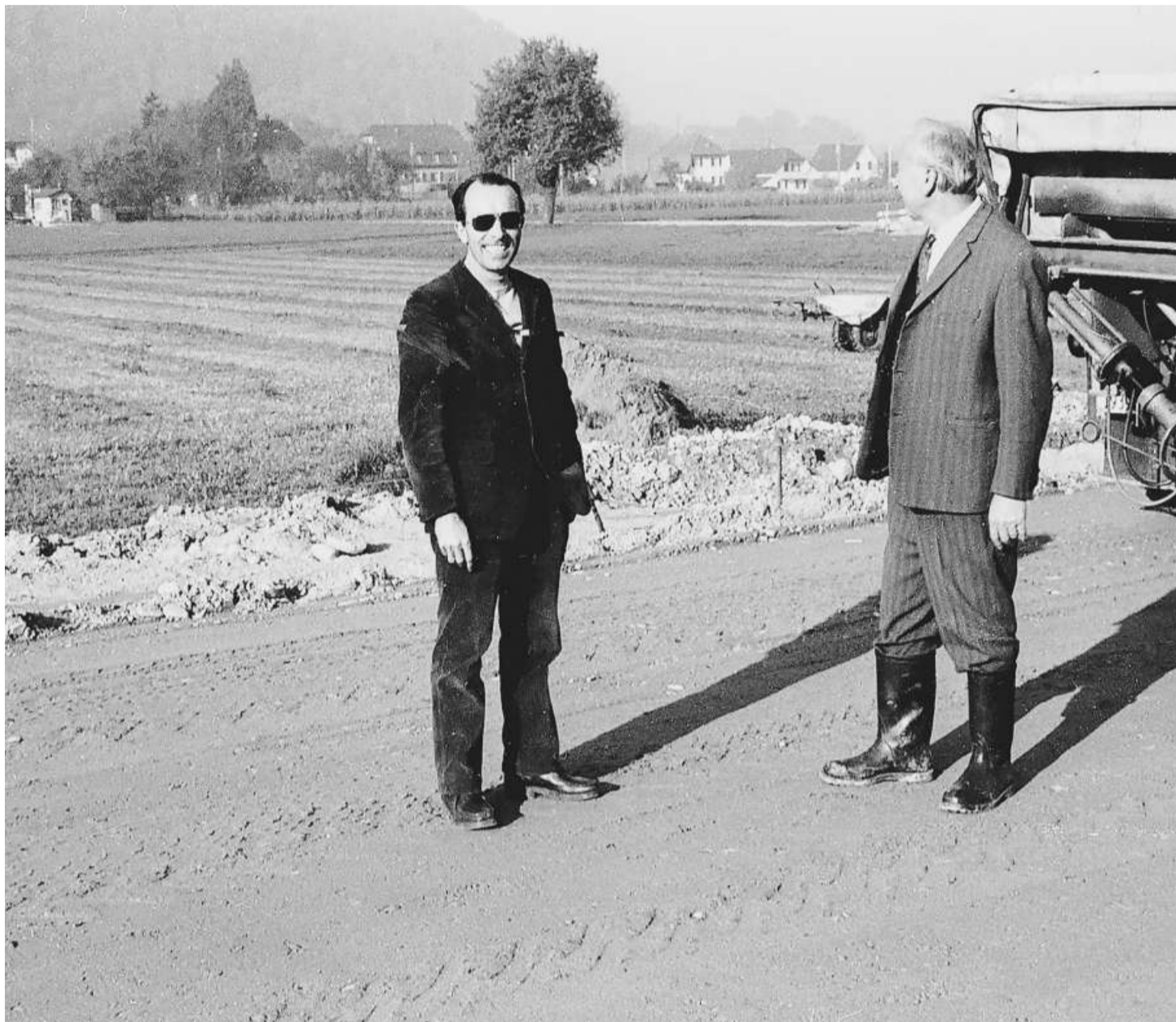
Herbert Otto (links) zusammen mit dem örtlichen Bauleiter 1975 auf der Baustelle des Autobahnzubringers Rothrist.
