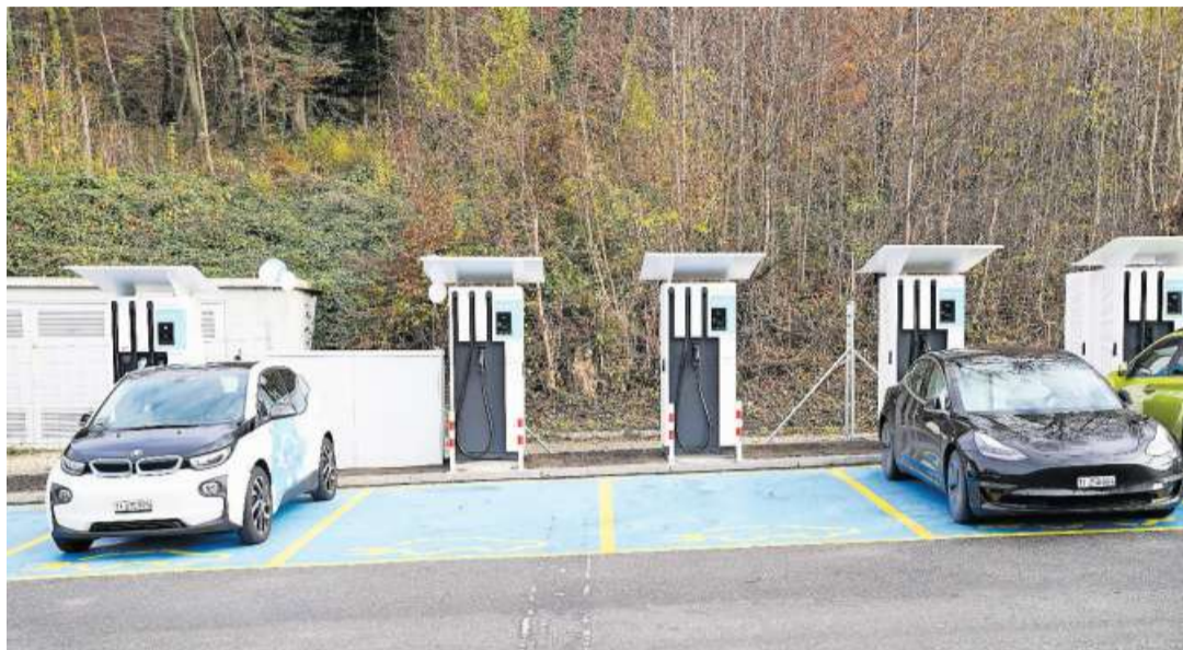
Immer stärker gefragt: E-Ladestationen auf der Autobahnraststätte Würenlos.
